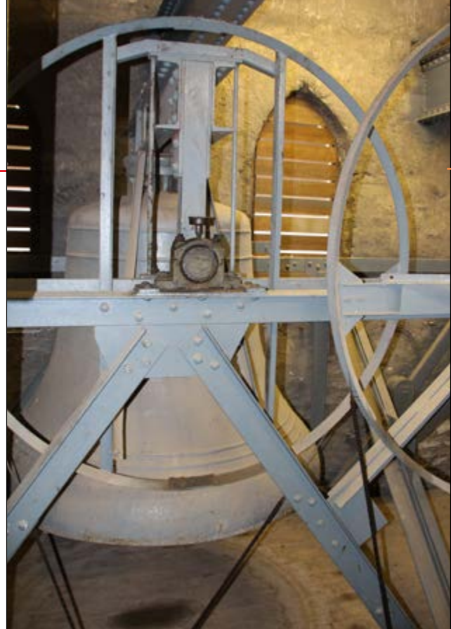
Der Stahlglockenstuhl aus der Nachkriegszeit ist nicht mehr reparabel.
